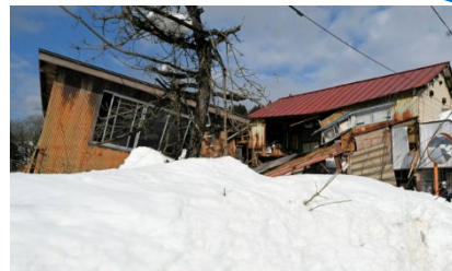
車庫部分が倒壊した家屋（新潟県柏崎市）
