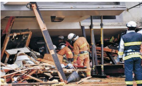
↑ビルの倒壊現場（3日の輪島市の様子）
