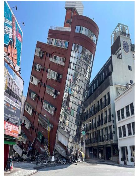
地震で被害を受けた建物＝台湾・花蓮（2024年04月03日）1999年の中部大地震以来耐震基準が強化されてきたが、まだまだ課題が多く残された古い建築物が存在している
